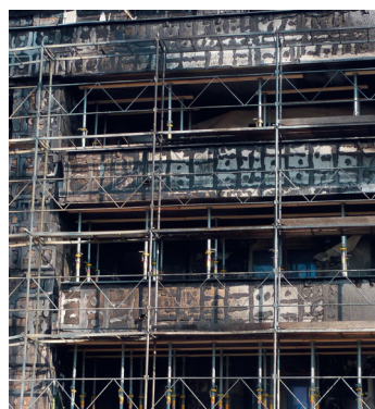
Der Brandfall zeigt Lücken im System schonungslos auf!
